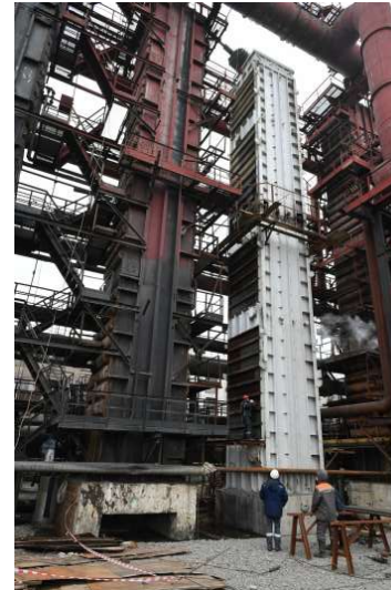
Станция газоочистки КХП
